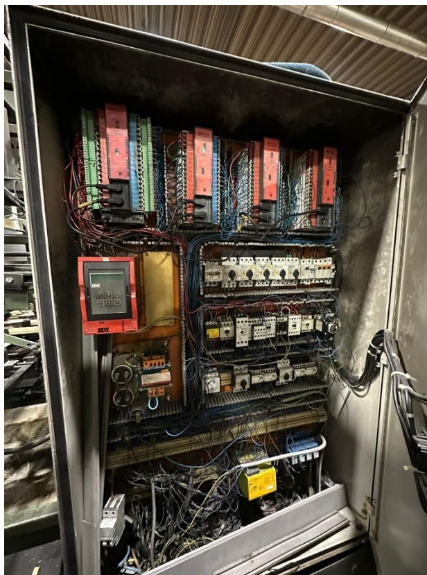
Abbildung 5: Bestandsschaltschrank der Palettenmaschine
