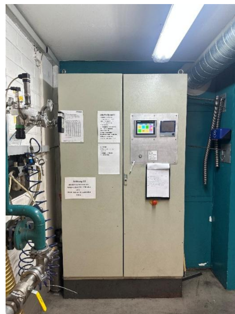
Abbildung 2-Bestehender Schaltschrank des Vakuumpumpenprüfstandes
