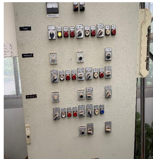
Bisherige Heizungsregelung (veraltet)
